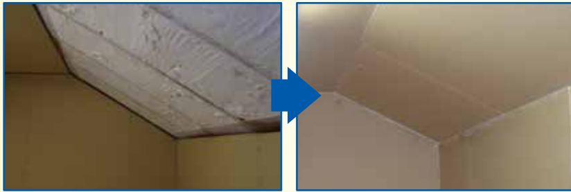
小屋裏収納や勾配天井は吹き付け後トリミング(カット)の後、ボードを貼って仕上げます。※2
