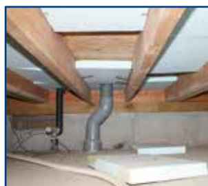
施工不良ではがれ落ちた断熱パネル
