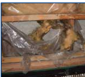
経年劣化したグラスウールの断熱材
